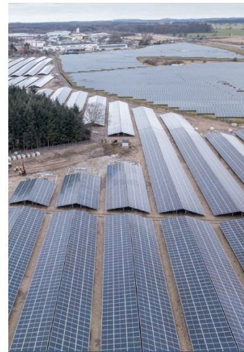
PV-Anlagen Ost-Wesausrichtung (© ib vogt)
