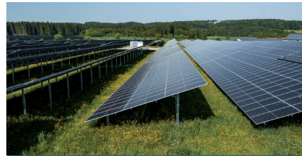
PV-Anlagen Südausrichtung (© ib vogt)
